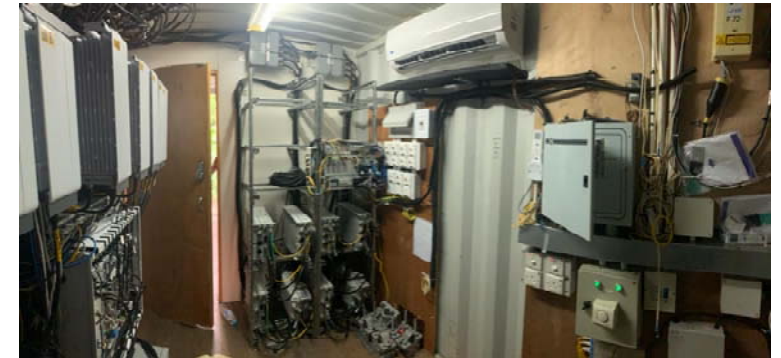
Mobile Equipment inside existing container Photo (D)
